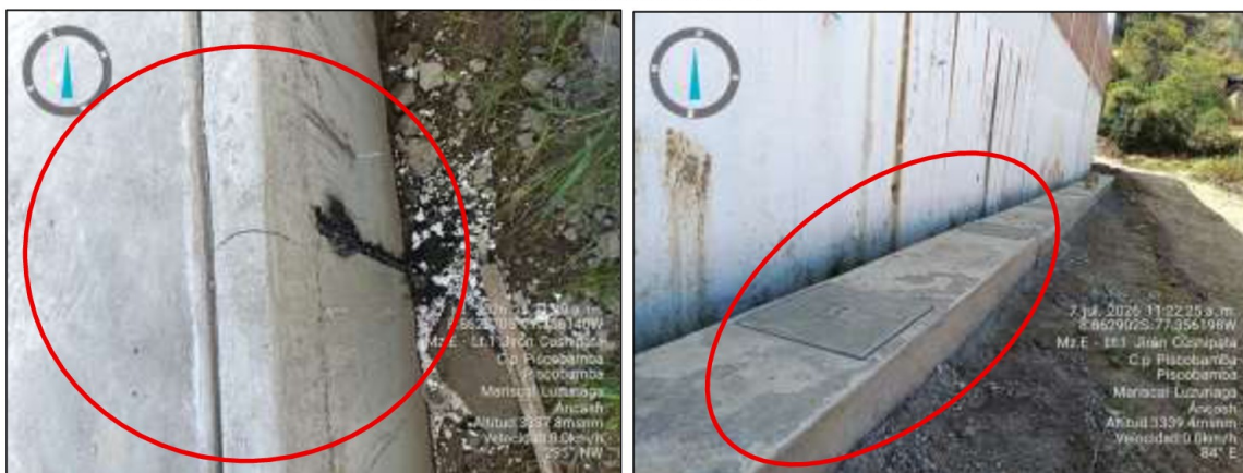
FOTOGRAFIA N° 23 Y 24 FISURAS Y HOLGURAS EXCESIVAS EN SECCIONES DE APOYO DE LAS TAPAS DE CONCRETO EN ALCANTARILLA
